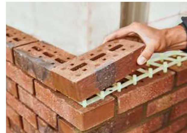
Vinyl-Verbinder und ein ablösbare Fugenmörtel halten diese Mauer zusammen.
